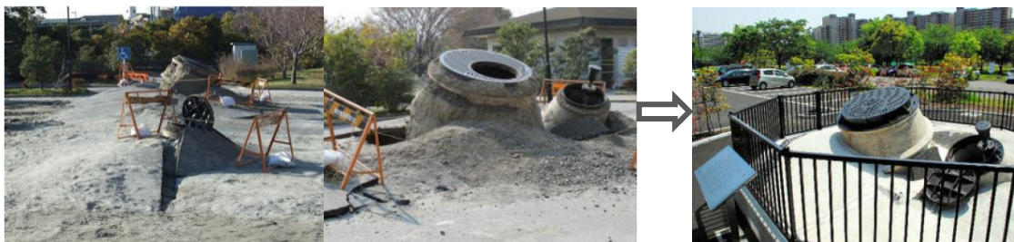
▲東日本大震災の発生により液状化現象が起こり、約1.5m浮きあがった状況。本来なら約100トンの水を供給でき、震度6の揺れにも耐えるはずでした。 ▲液状化の被害を後世に伝えるため、震災遺構となりました。
